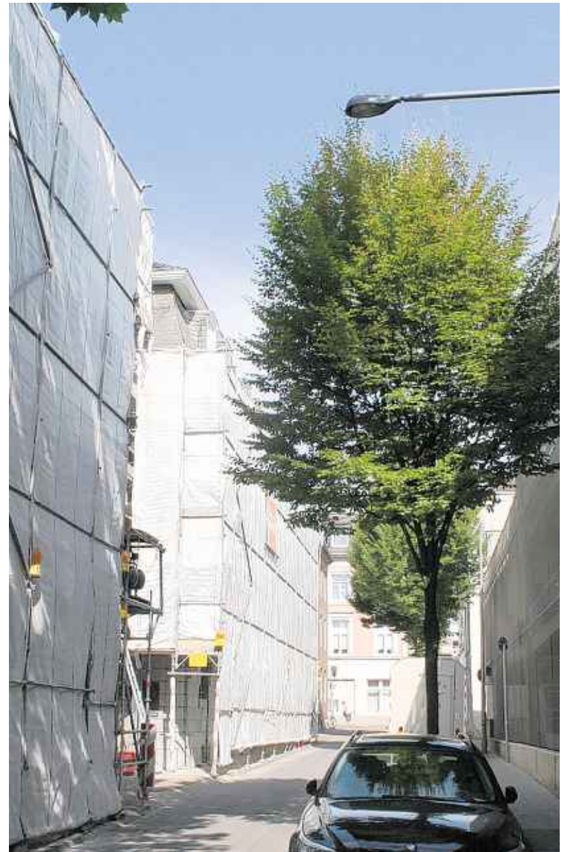
Gut und vor allem sicher verpackt: Das Haus der Evangelischen Kirche hinter dem Parkhaus Jesuitenstraße (rechts) versteckt sich hinter einem Bagerüst. Die Fassade muss saniert werden. Fotos: Thorsten Karbach
